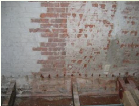
De muren dienen volledig afgehakt te worden. Dus niet zo!
