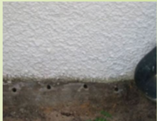
Stukadoren boven de injectielijn. Tenzij een afdichtingslaag is toegepast.
