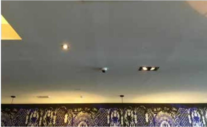
Scheuren in de plafonds door te droge en te warme lucht tijdens het gebruik.
