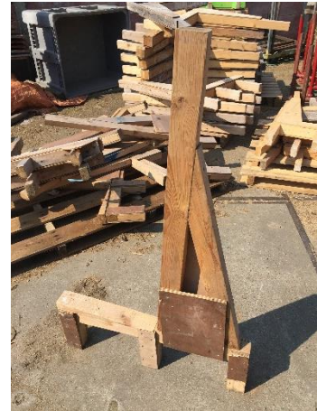
Figuur 13: Afdekplaat te klein
