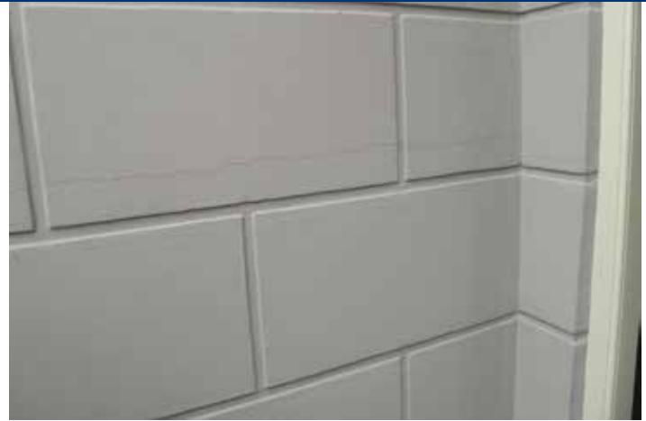
Het fraai gestucte blokverband stucwerk vertoont op allerlei plaatsen scheuren.
