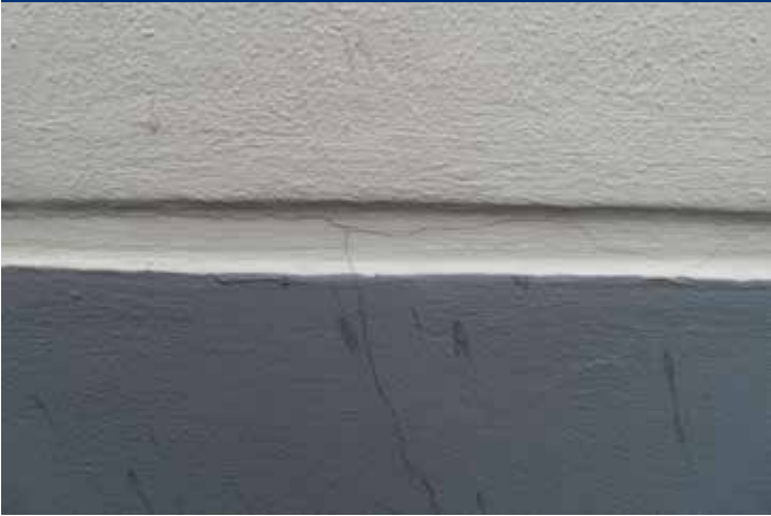
Doordat de meeste scheuren vrij subtiel ogen, zoekt men de oorzaak in het stucwerk zelf. De onafhankelijk technische deskundige bevestigt echter de constructieve aard.
