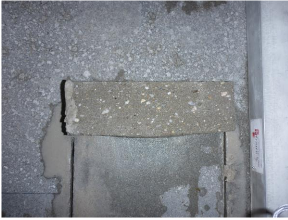
Figuur 16 Representatief monster van met mechanische rei vervaardigde, verend opgelegde dekvloer. Verdichting oogt zonder meer goed en over de laagdikte constant.
