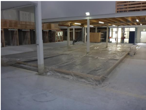
Figuur 25 Bij beproeving van de proefvloeren fase 2 is de folielaag nog netjes intact aanwezig.
