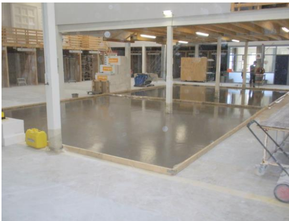
Figuur 2 Op scheidingsfolie is een zeer sterke cementgebonden gietvloer aangebracht als ondergrond voor de proefvloeren.
